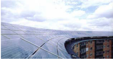
TETTO FOTOVOLTAICO SU VECCHIO EDIFICIO
